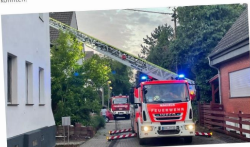
Die Feuerwehr half kaputte Dächer provisorisch abzudecken
